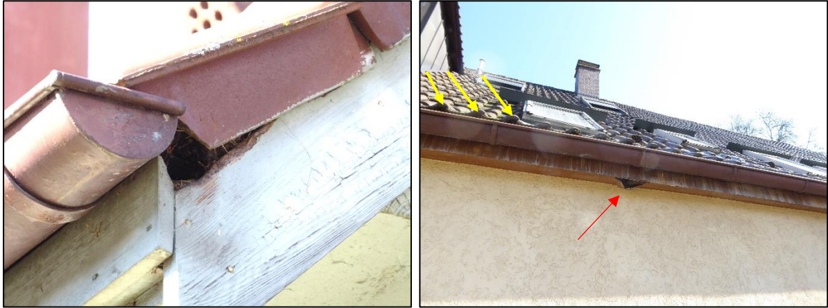
Abbildung 9: Schadstellen an den Gebäuden der Seestraße 14 (linkes Bild) und der Seestraße 10 (rechtes Bild, roter Pfeil). Im linken Bild ist zudem altes Nistmaterial erkennbar. Die gelben Pfeile im rechten Bild weisen auf potenzielle für gebäudebrütende Vögel geeignete Strukturen im Übergangsbereich von Regenrinne zu Dachziegeln hin.
