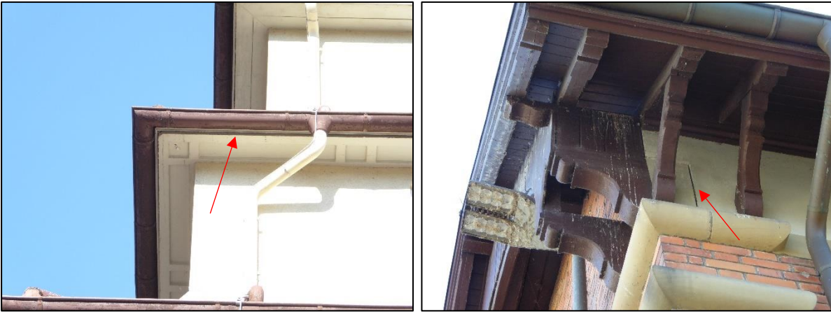
Abbildung 7: Für gebäudebewohnende Fledermäuse geeignete Spalten an den Gebäuden der Allee 16 (linkes Bild) und der Stuttgarter Straße 21 (rechtes Bild). Das rechte Bild zeigt zudem Kotspuren von Vögeln im Bereich des Gebälks.
